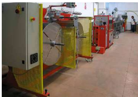
LINEA PER PRODUZIONE TUBI PIPES PRODUCTION LINE
